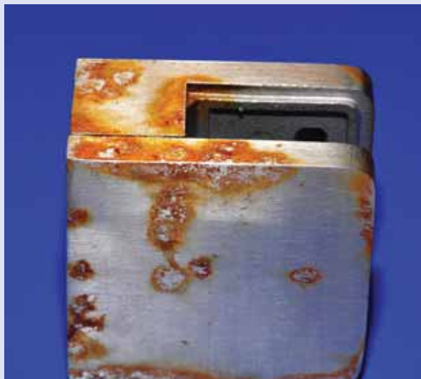
Overfladiske grubetæring i en glasholder af 4301-stål som følge af havsalt. Risikoen for funktionssvigt er meget ringe, og selvom det kan se nok så voldsomt ud, er skaden mest af kosmetisk karakter ("Rustfrit stål & korrosion", kapitel 7.2).
